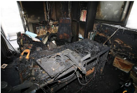
写真7 事務室の焼損状況
