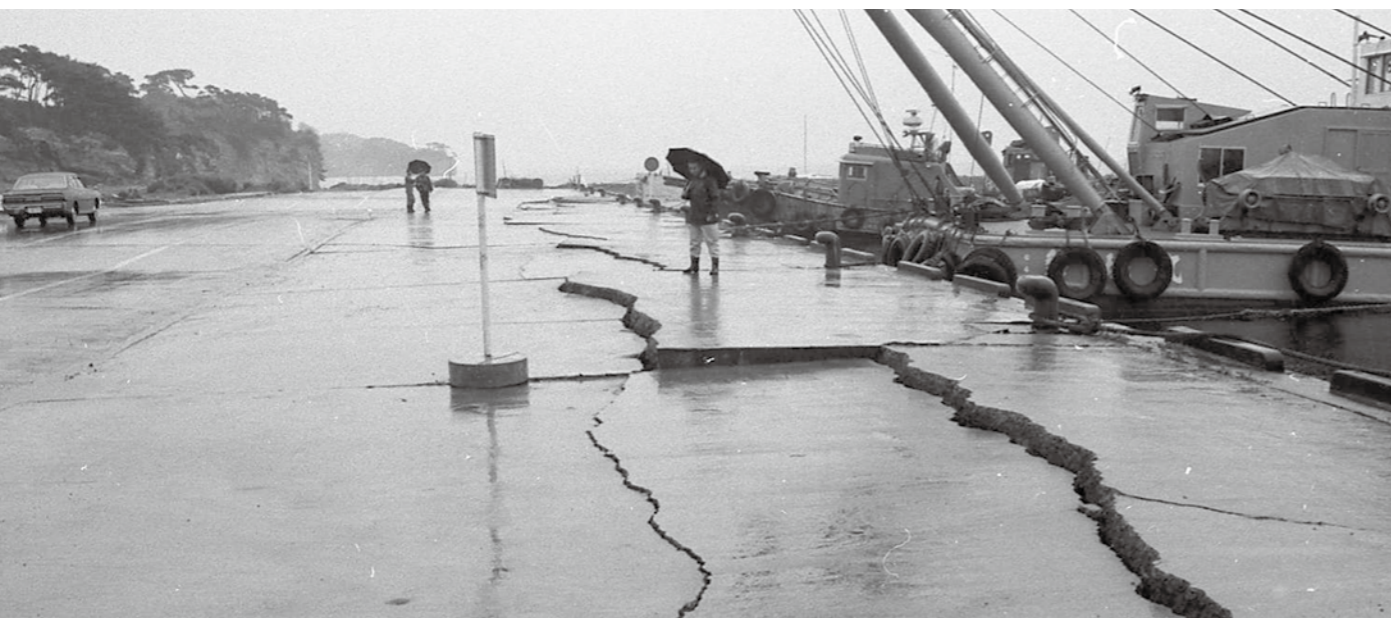
大きなヒビが入り陥没した魚市場係船岸壁
